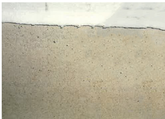
Particolare protettivo al termine della prova.
